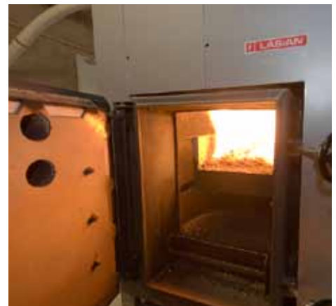
Caldera de Biomasa
