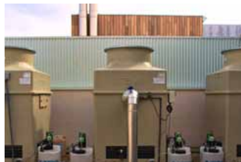
Torres de refrigeración
